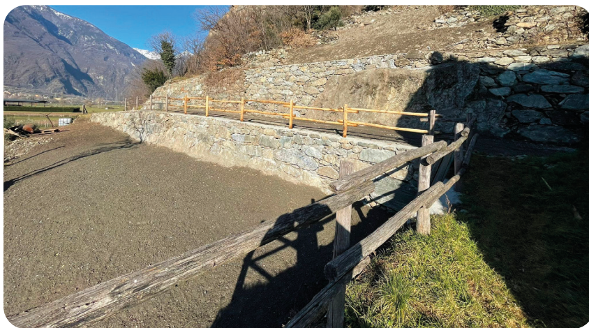
FRANA CLOS DE BARNE RIPRISTINO
